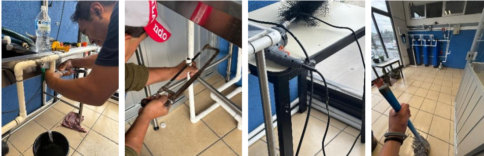
Fotografía 23. Mantenimiento preventivo y correctivo a la planta purificadora de agua.
