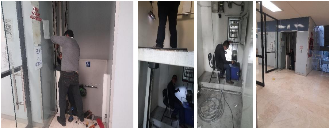
Fotografía 48.. Mantenimiento preventivo al elevador.
